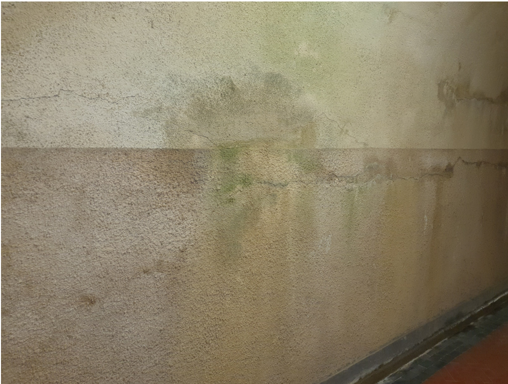
Foto 19 – Macchia di acqua sulla parete sinistra circa alla progressiva +35.5m (vedere punto B in Allegato 5).
