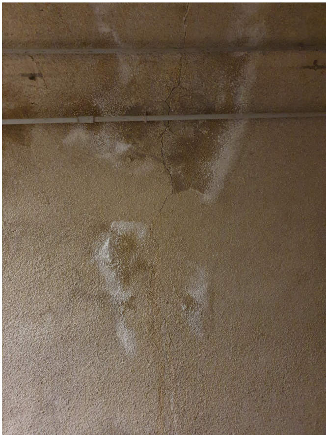
Foto 29 – Altra foto della lesione ad arco presente alla progressiva +15m; si notano segni di umidità e efflorescenze saline (vedere punto H in Allegato 5).
