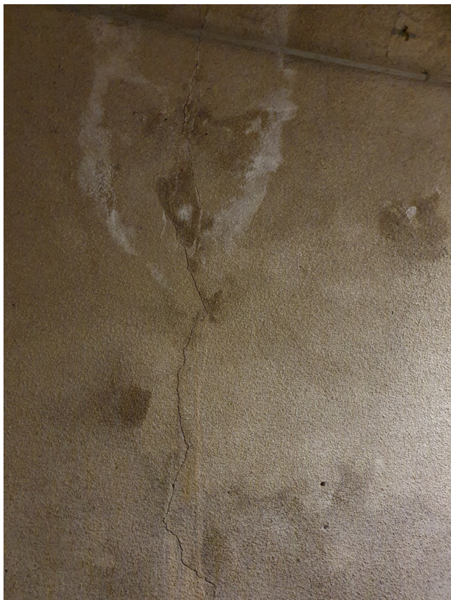
Foto 27 – Altra foto della lesione ad arco presente alla progressiva +15m; si notano segni di umidità e efflorescenze saline (vedere punto H in Allegato 5).
