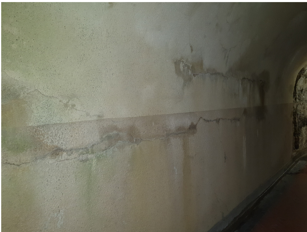
Foto 18 – Lesione orizzontale sulla parete sinistra ad altezza 1.7 m da terra tra le progressive +31m e +39m; detta lesione si sovrappone parzialmente a quella della foto precedente nelle sezioni tra +37m e +39m; macchie di acqua circa alle progressive +31.5m e +35.5m (vedere punto B in Allegato 5 ).
