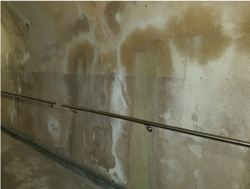
Foto 25 – Lesione verticale sulla parete destra alla progressiva +9m alta circa 1.7m da terra con macchia di acqua a circa 1m da terra (vedere punto F in Allegato 5).
