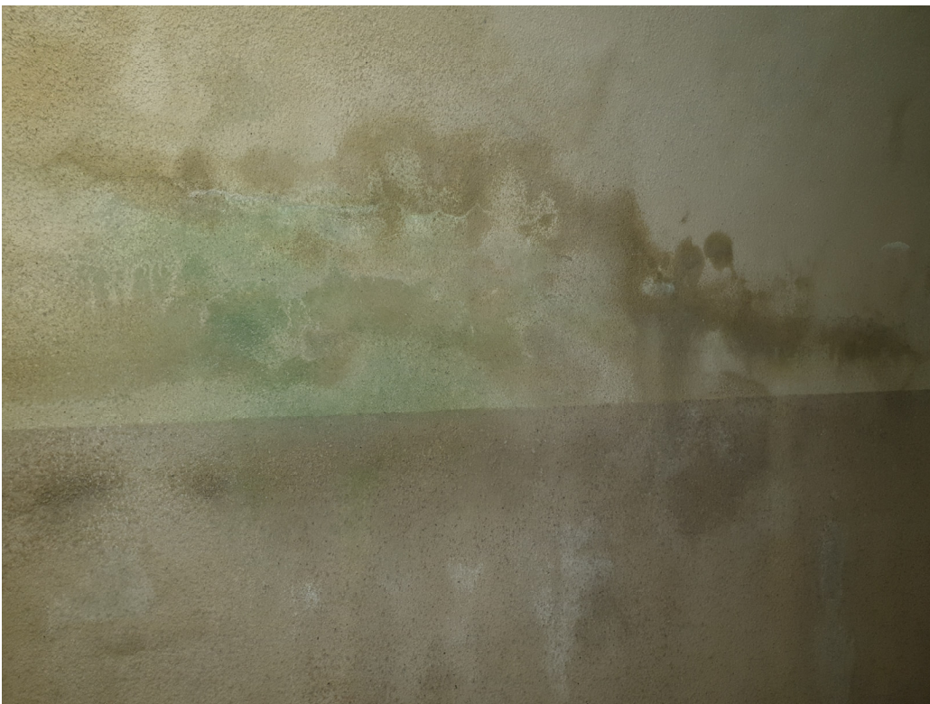
Foto 20 – Macchia di acqua sulla parete sinistra circa alla progressiva +31.5m (vedere punto B in Allegato 5).
