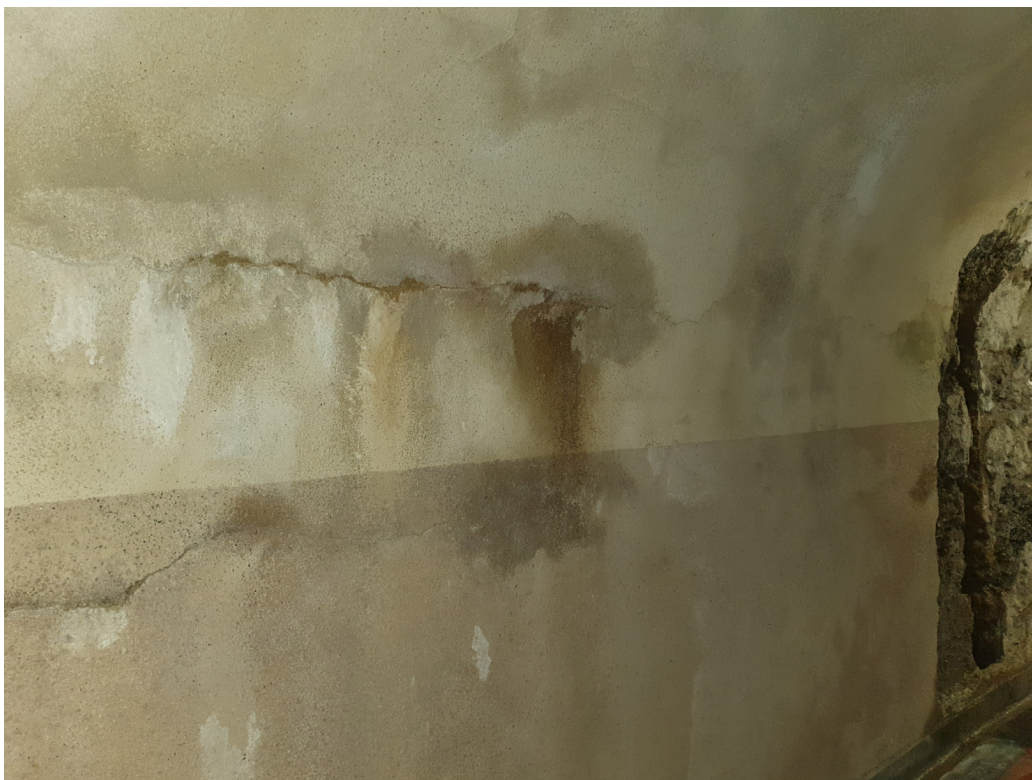
Foto 17 – Lesione orizzontale sulla parete sinistra ad altezza 1.95 m da terra tra le progressive +37m e +45m; specie nel tratto tra +37m e +40m vi è una evidente macchia di umidità (vedere punto A in Allegato 5 ).
