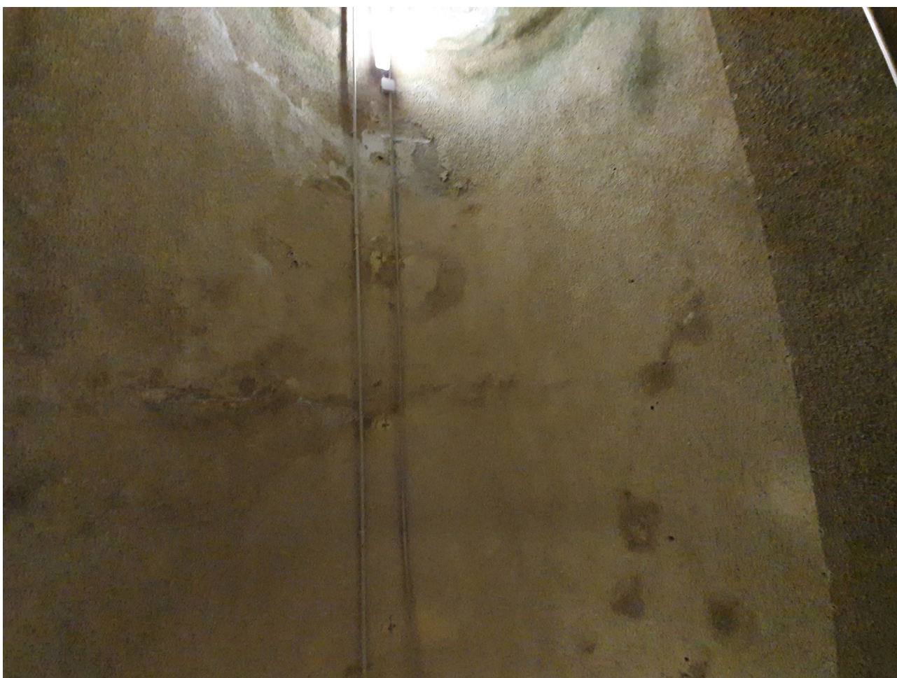
Foto 32 – Macchia di umidità in volta circa alla progressiva +22m con presenza di efflorescenze saline (vedere punto M in Allegato 5).
