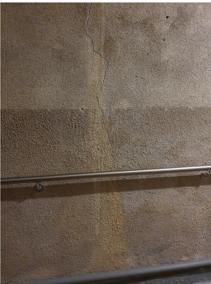
Foto 26 – Lesione verticale ad arco che interessa l'intera sezione della volta; la lesione è presente alla progressiva +15m; in foro si osserva la lesione sulla parete destra (vedere punto H in Allegato 5).
