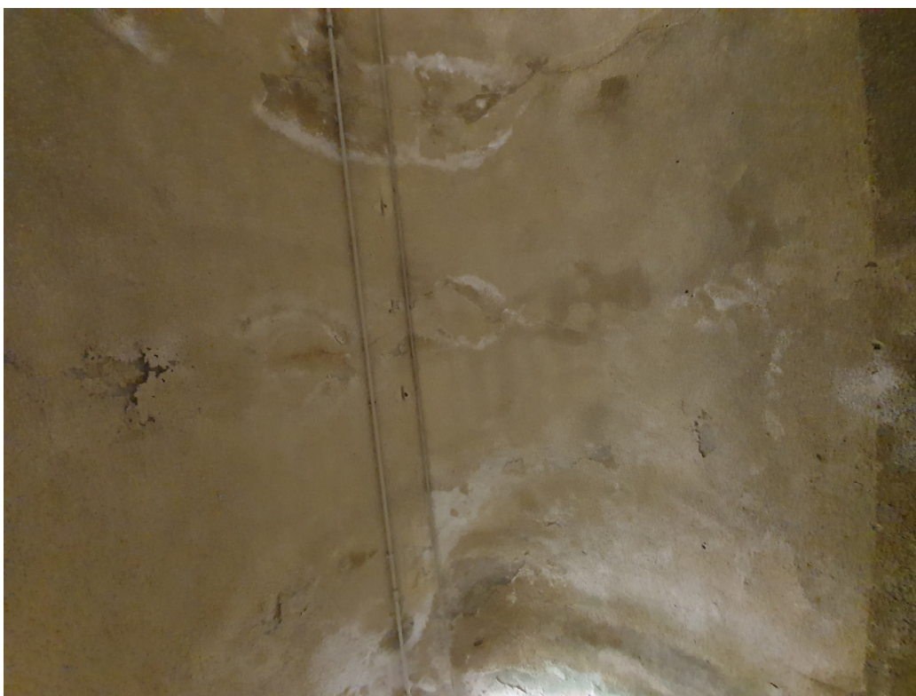
Foto 30 – Lesione sulla volta del tunnel in corrispondenza della progressiva +16m; sono presenti macchie di umidità e efflorescenze saline (vedere punto I in Allegato 5).
