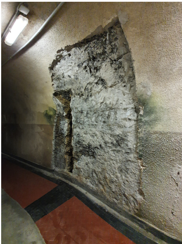
Foto 10 – Porzione di intonaco rimosso alla progressiva +40m e scolo verticale rinvenuto (foto del 13/07/2020).
