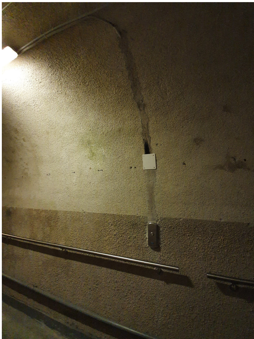
Foto 33 – Presenza di muffa per probabili percolazioni interne di acqua in corrispondenza della crena eseguita per l'installazione del pulsante di chiamata dell'ascensore alla progressiva +24m circa.
