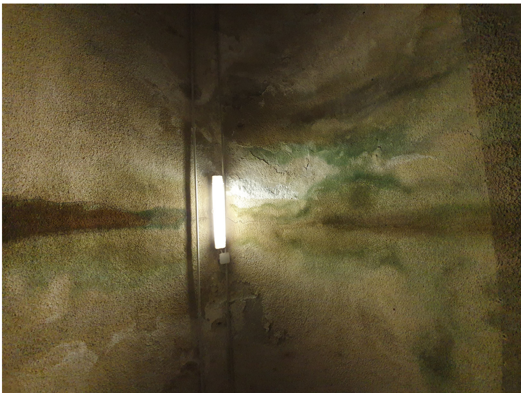
Foto 31 – Lesione sulla volta del tunnel in corrispondenza della progressiva +19m; è presente una vistosa colatura di acqua, macchie di umidità, efflorescenze saline e muffa generalizzata (vedere punto L in Allegato 5).
