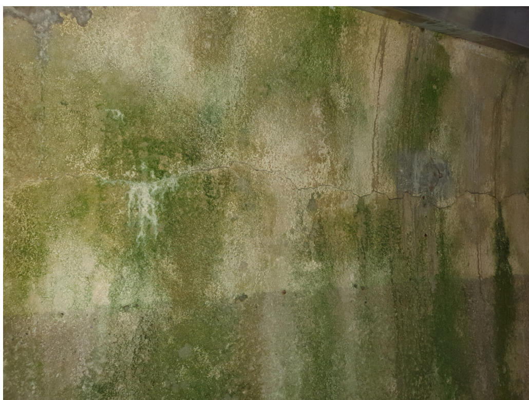
Foto 22 – Dettaglio della parete destra di cui alla precedente fotografia (vedere punto C in Allegato 5); più avanti, tra le progressive +27m e +32m è presente una lesione orizzontale ad altezza 2.0m da terra senza presenza di venute d'acqua (vedere punto D in Allegato 5).
