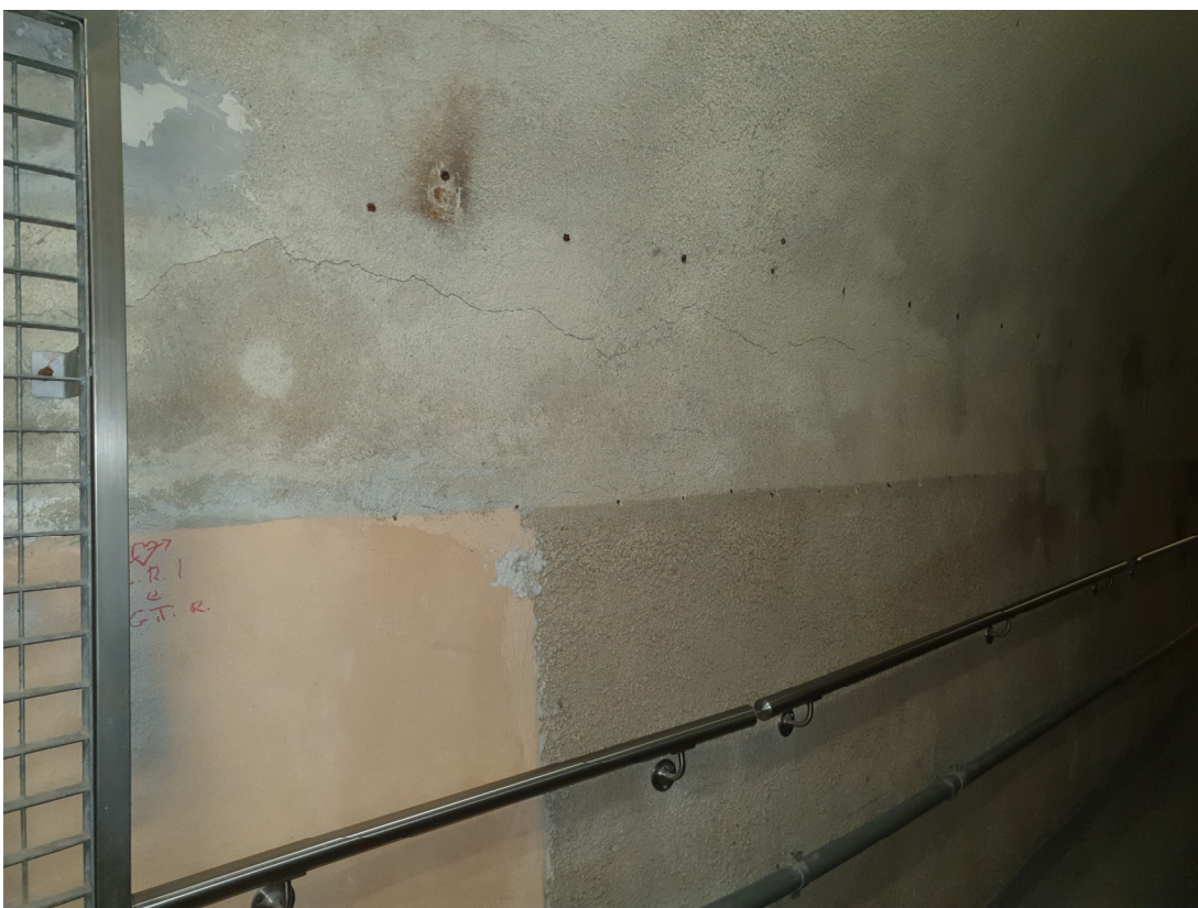
Foto 24 – Lesione orizzontale sulla parete di destra ad altezza 1.95 m da terra tra le progressive +35m e +45m; la lesione fronteggia quella del punto A e non presenta segni evidenti di venute d'acqua (vedere punto E in Allegato 5).
