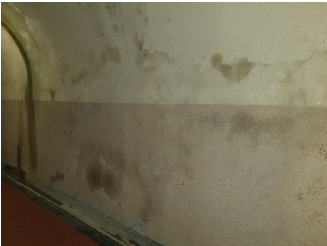
Foto 23 – Macchia di umidità sulla parete sinistra circa tra le progressive +20m e +25m senza la presenza evidente di lesioni.
