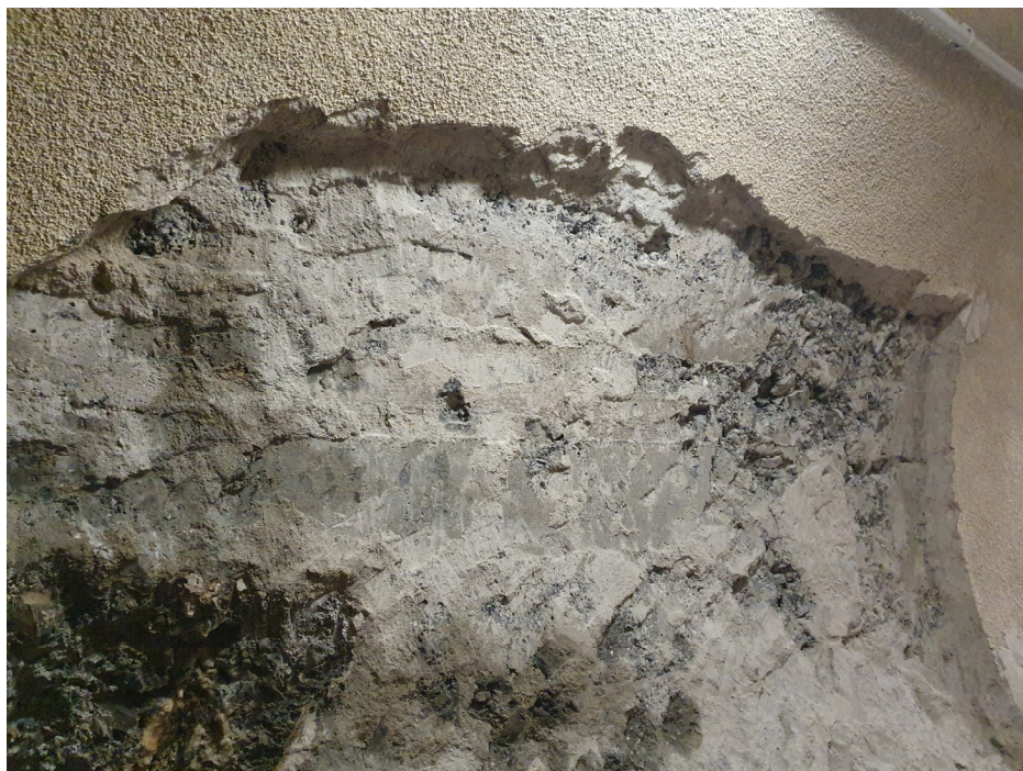
Foto 14 – Dettaglio della porzione di intonaco rimossa (di spessore decimetrico in alcuni punti): si nota che la parete del tunnel è stata realizzata gettando conglomerato cementizio (non armato) direttamente contro la roccia scavata; si notano nella fotografia i segni orizzontali delle tavole di legno impiegate per il getto del rivestimento (foto del 13/07/2020).
