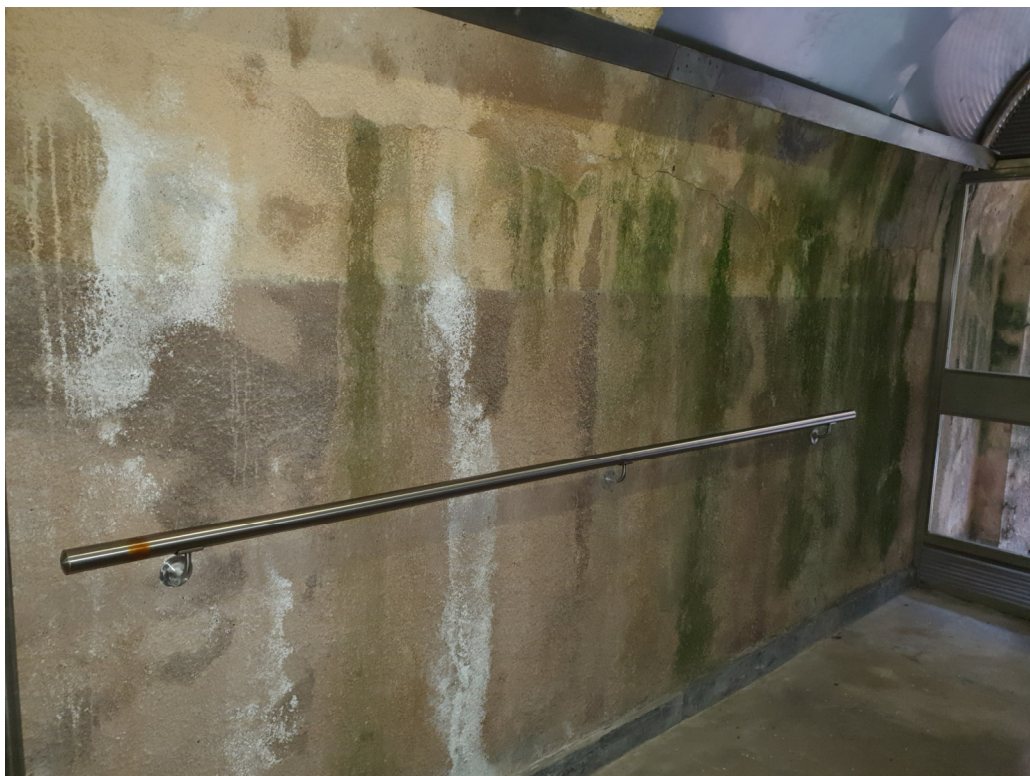
Foto 21 – Lesione orizzontale sulla parete destra ad altezza 1.7m tra le progressive +0m e +4m; presenza di molta umidità, efflorescenze saline e muffa (vedere punto C in Allegato 5).
